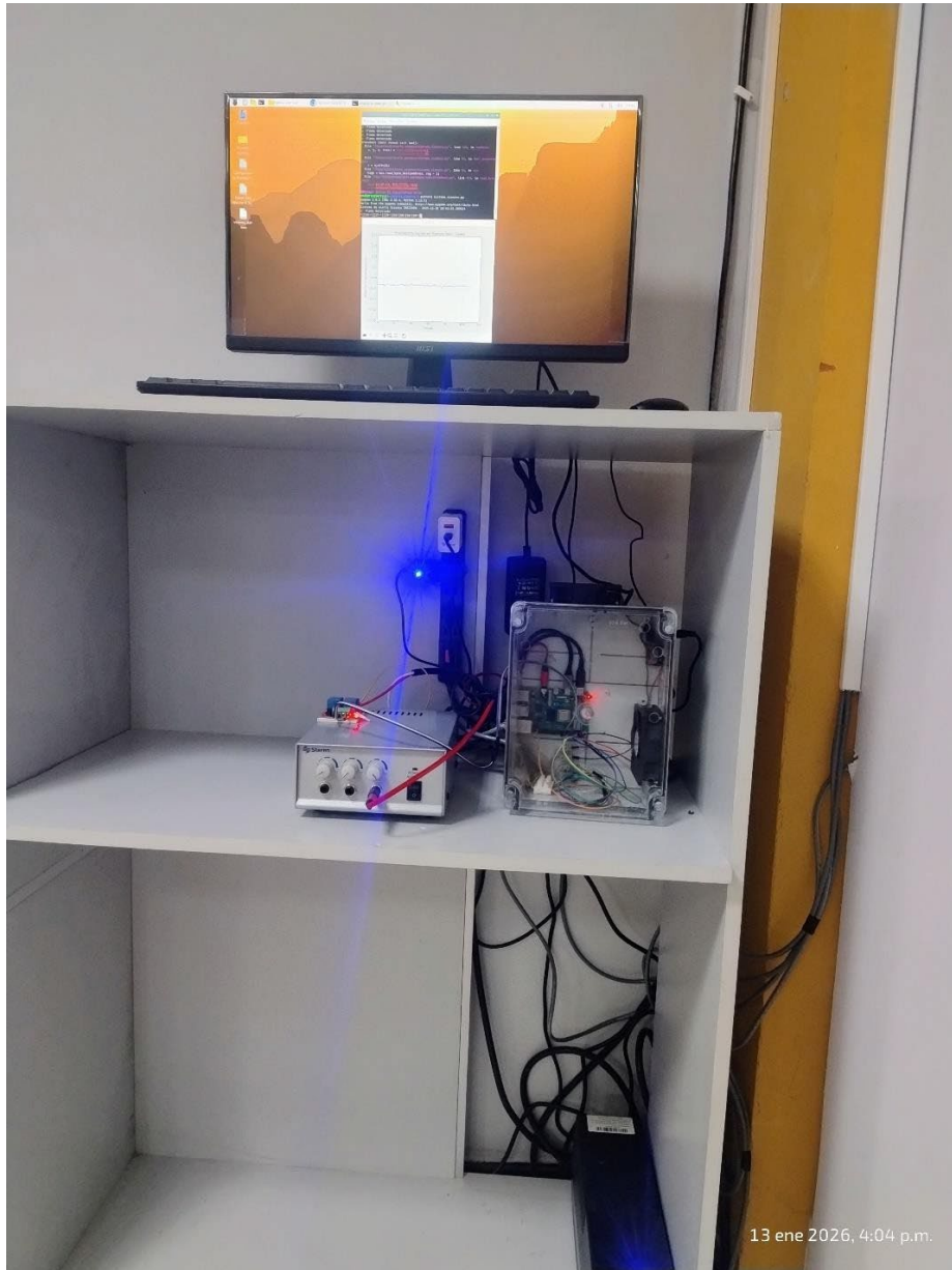
Figura 17. Componentes del sistema instalado en Regional San Salvador.
