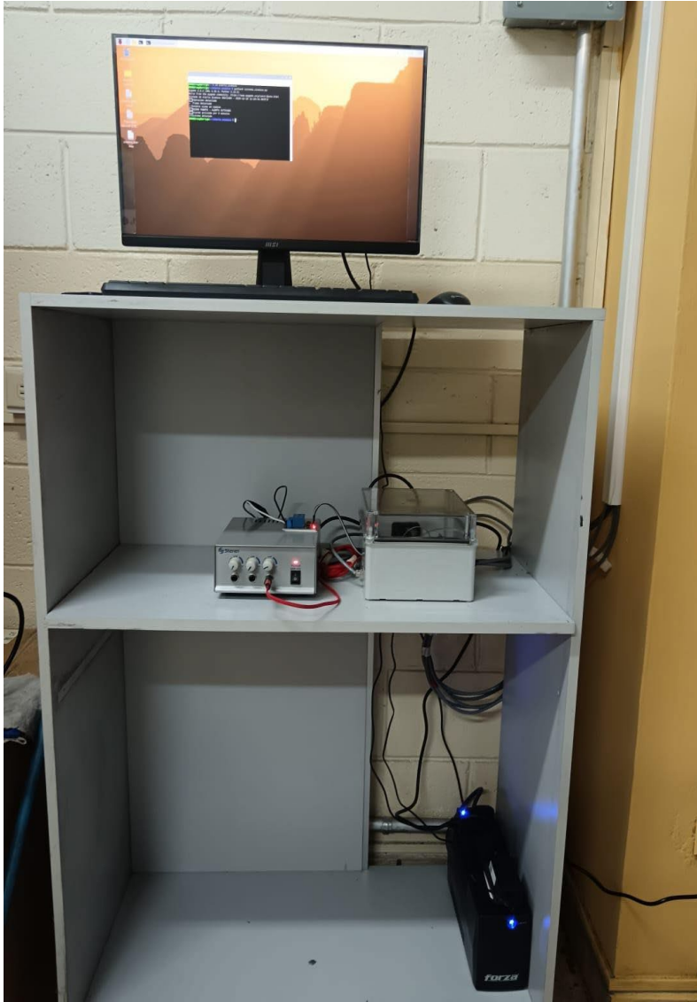
Figura 18. Componentes del sistema instalado en Regional San Miguel.
